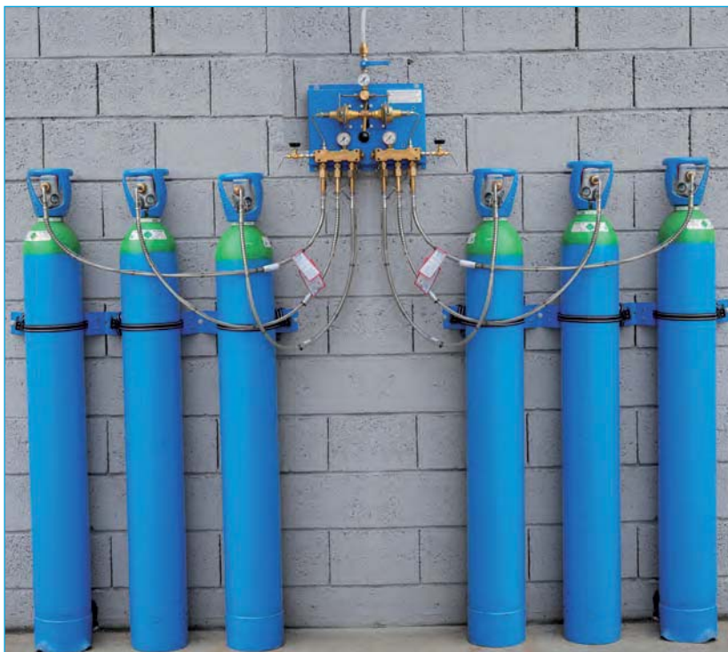
Centrale a inversione automatica a riarmo manuale (Nessuna interruzione dell'erogazione di gas)
